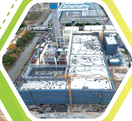
污泥处置中心
