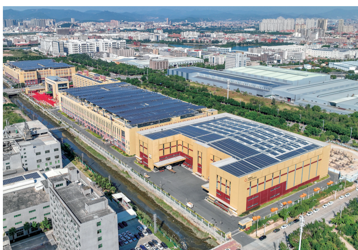
凤竹纺织厂房屋顶安装了光伏发电系统。
