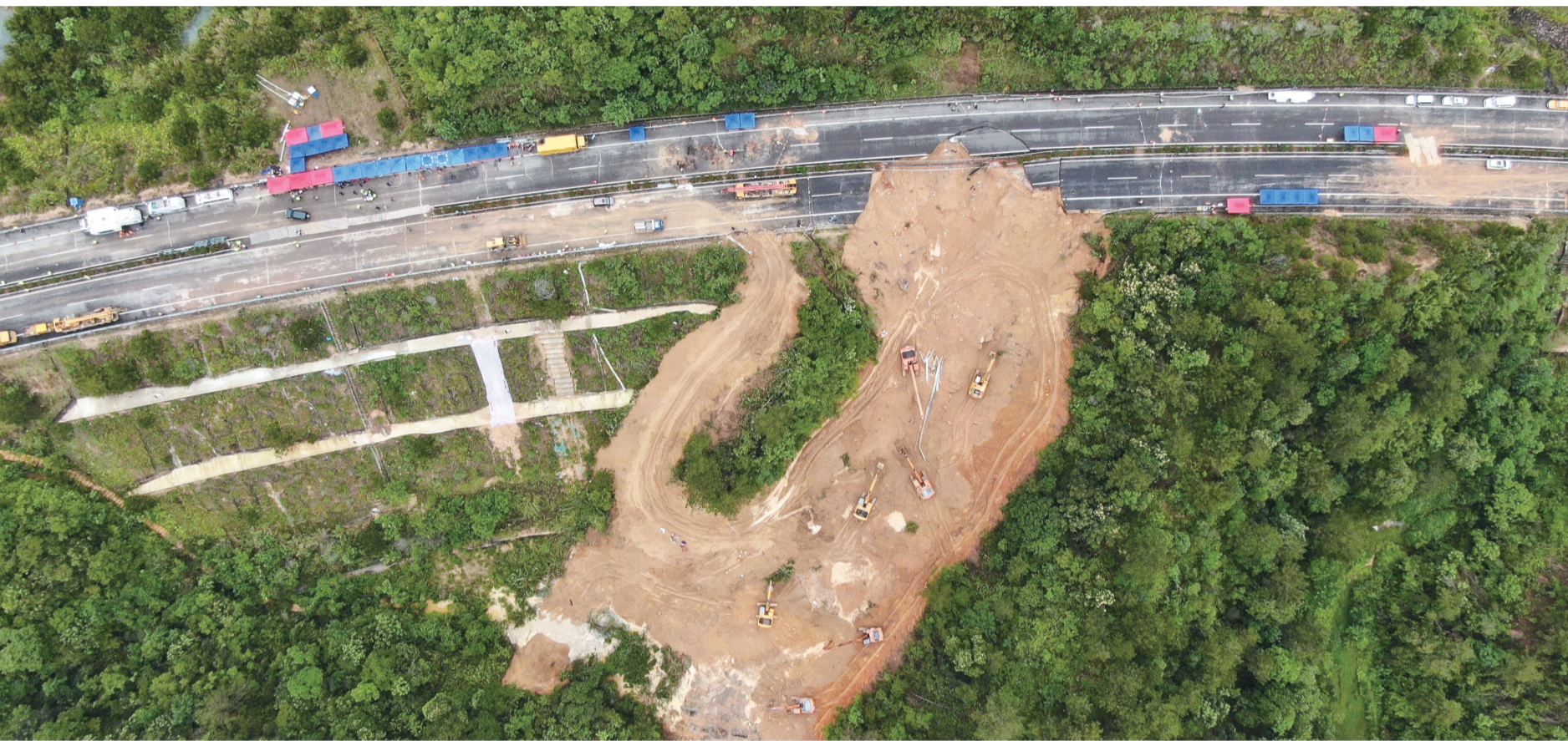
5月2日拍摄的广东梅大高速茶阳路段塌方灾害现场(无人机照片)。新华社记者 王瑞平 摄
