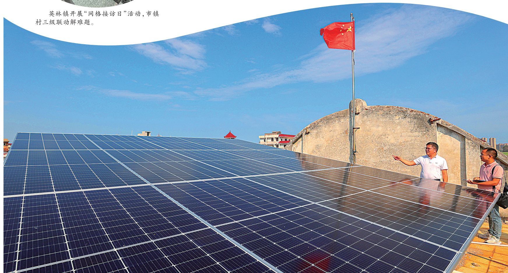
光伏发电成为英林镇发展壮大村集体经济的新平台。
