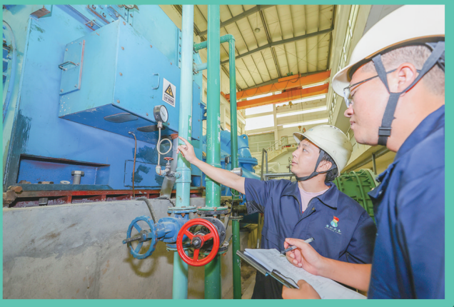
晋江王厝泵站,工作人员王嘉峰和吴和顺正在对设备进行检查,保障引自金鸡拦河闸的水汨汨流向龙湖。
