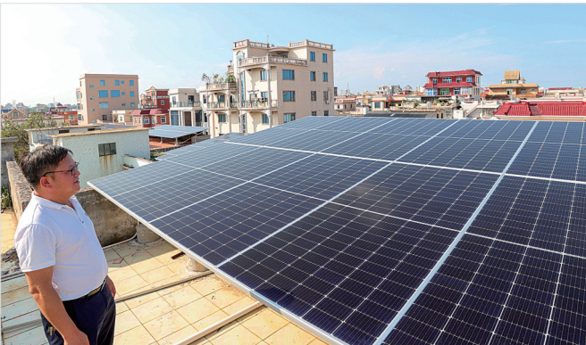
英林镇港塔村光伏发电项目。
