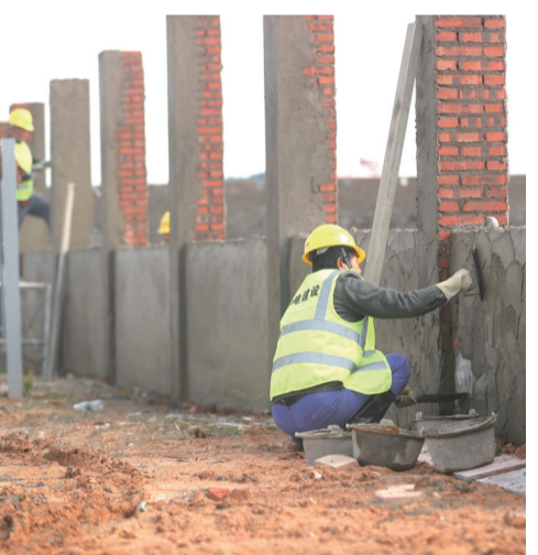
中建佳园绿色建材泉州区域总部及产研基地项目建设现场,工人们正忙着项目建设前期准备工作。
