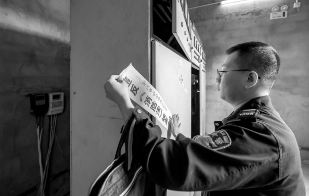
工作人员对违规厂房的电表箱进行查封。
